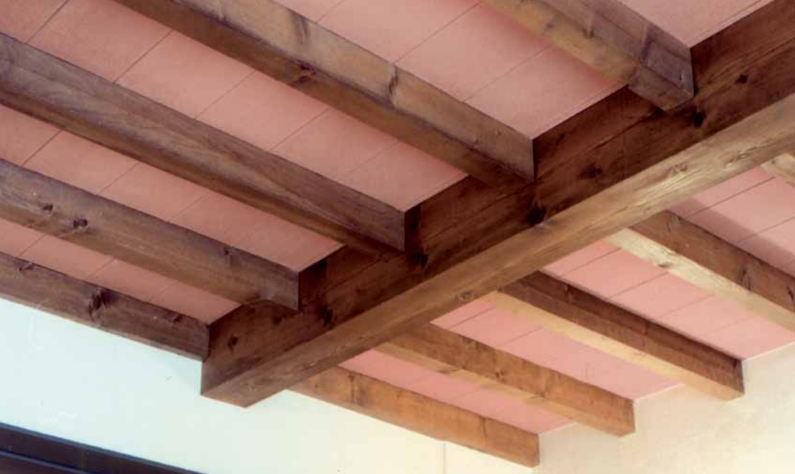
Solaio doppia orditura trave principale e trave secondaria fissate in luce, con tavelle in laterizio
